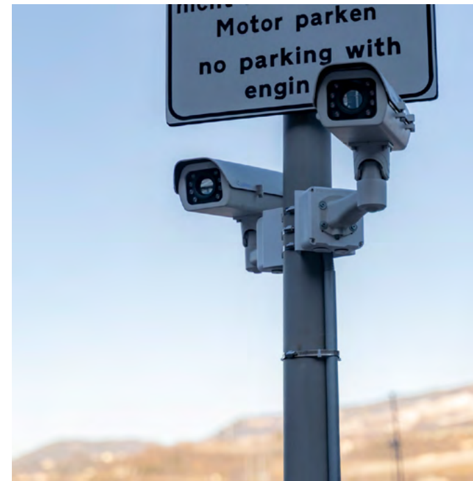
Sistema regolamentazione accesso veicolare - Interporto (TN)
